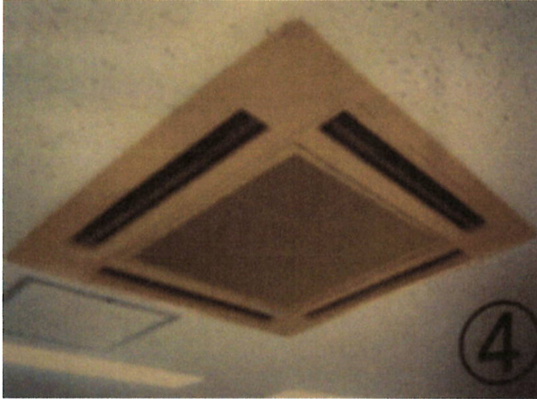
2・8F空調機フェイス施工前
